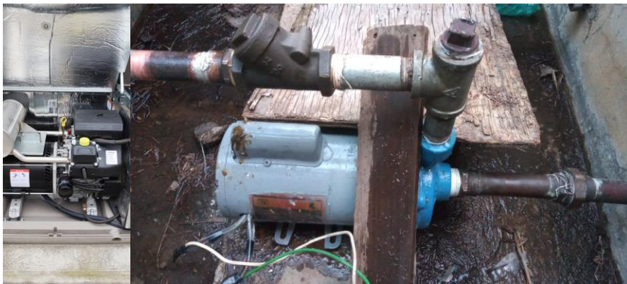
Imagen 132. Mantenimiento a equipos del CUVM
