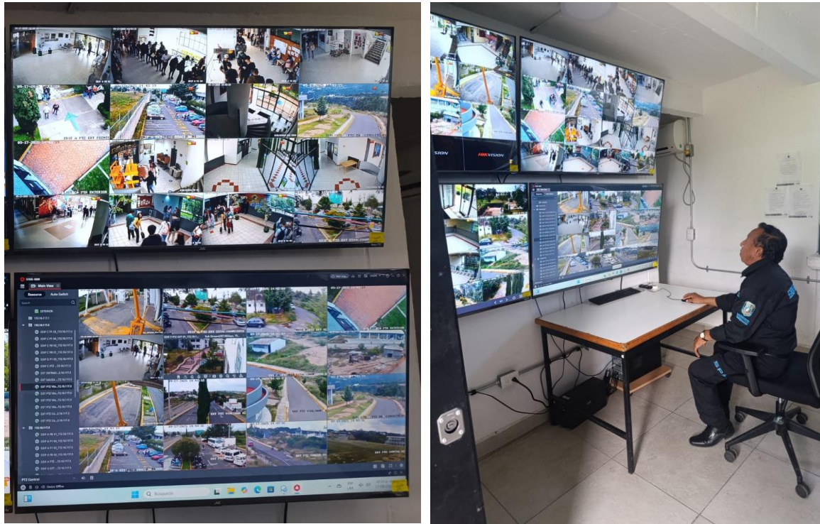
Imagen 46: Imagen Monitoreo CCTV
