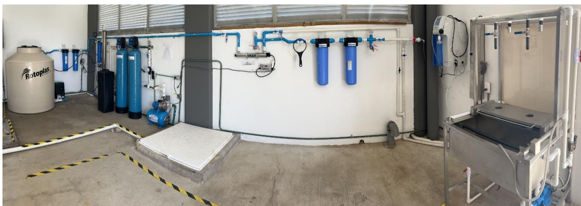
Sistema de purificación de agua de lluvia ICAR.
