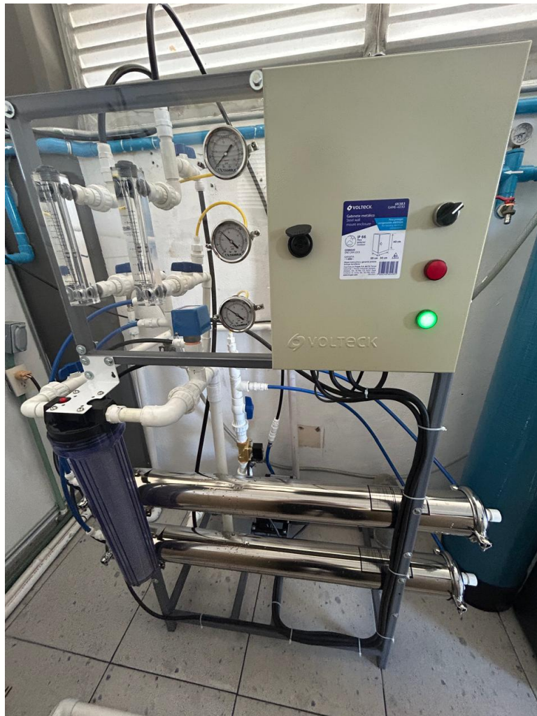
Imagen 30. Renovación del sistema de osmosis inversa del sistema de purificación de agua de lluvia ICAR.
