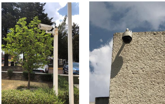
Cámaras de vigilancia
