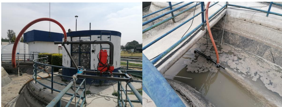
Figura 14.1 Dispositivos de aireación tipo venturi en la zanja activada de la planta de tratamiento.
