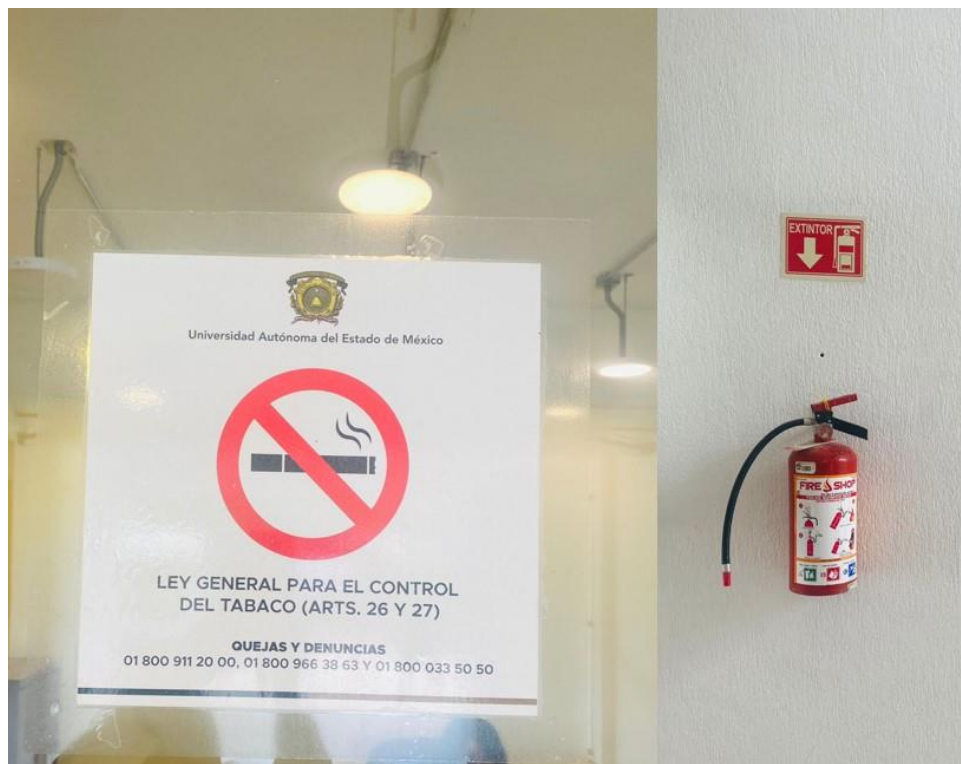
Figura 4. Espacios 100% libre de humo y extintores instalados
