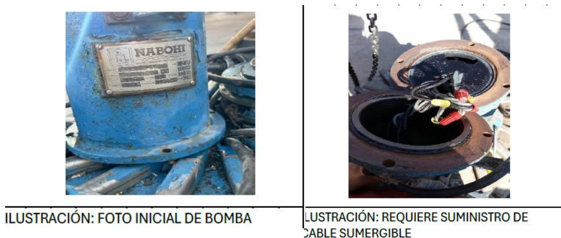
Figura 0.9 Reporte fotográfico de mantenimiento de bombas.
