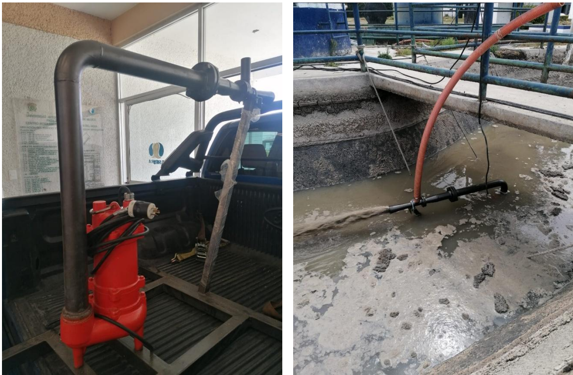
Figura 0.1 Equipos de aireador-difusor tipo Venturi instalados en la PTAR.
