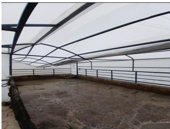
Figura 0.10 Falla de la estructura de invernadero.
