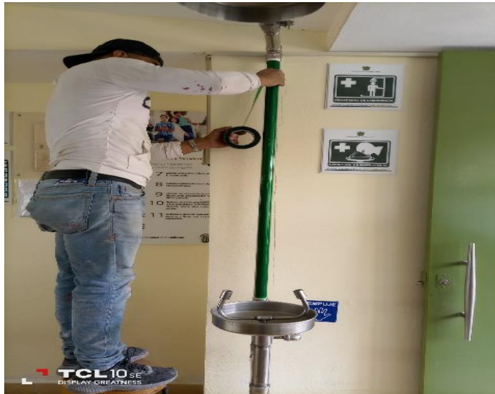
Señalización de tuberías
