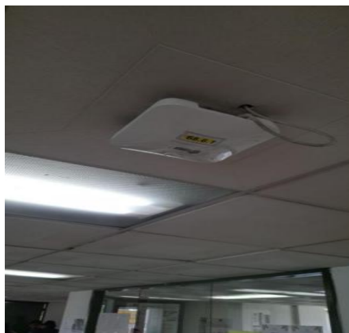
Imagen 40. Sustitución de access point.
